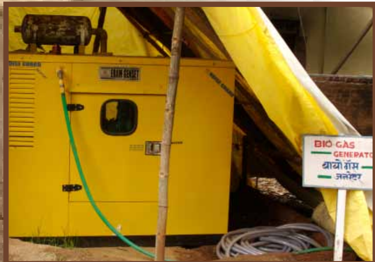
15 KVA/12KW Biogas Generator
